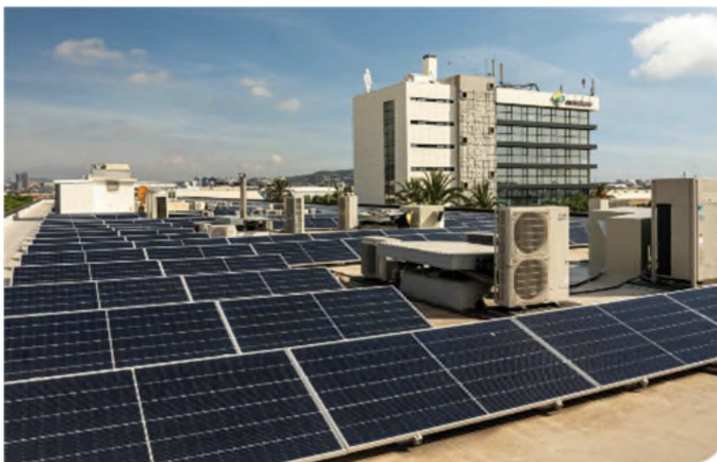
Figura 13: Plaques fotovoltaïques a les cobertes de Mercabarna.
