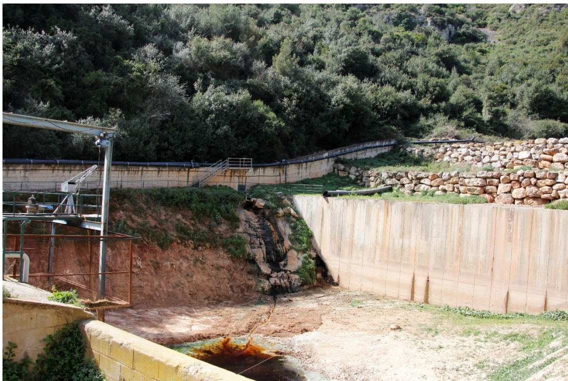
Figura 8.57. Zona on s'observa potencial infiltració directa dels lixiviats als materials carbonàtics del Juràssic, aigua avall de la vall de Joan abans de la planta de tractament de lixiviats.
