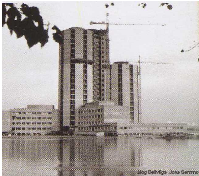
Figura 2.2.4. Inundacions a l'Hospital de Bellvitge (J. Serrano)
