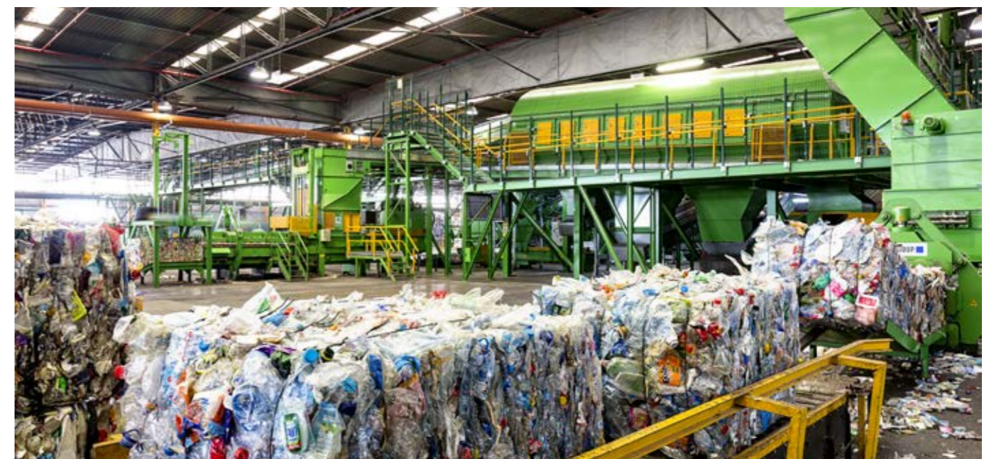
Gavà-Viladecans sorting plant. Source: AMB
