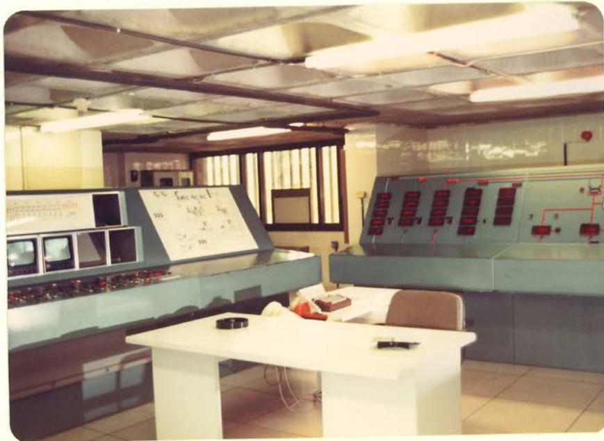
SALA DE CONTROL
