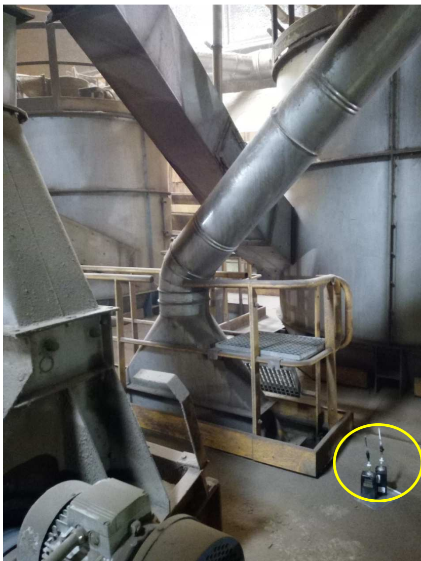
Figura 4. Punt de presa de mostres Nau Afinament
