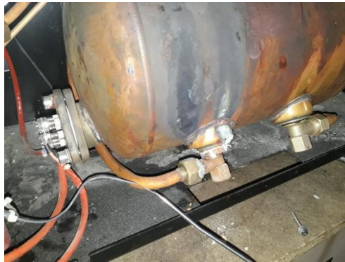
Figura 2. Caldera de coure i l'efecte de la corrossió de l'aigua amb alt contingut de calç sense filtrar.
