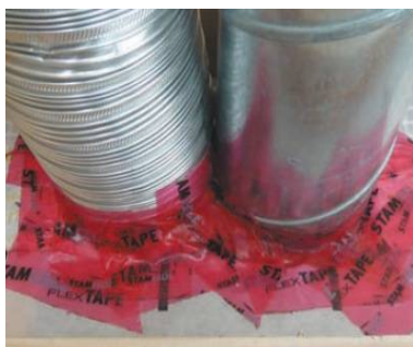
Exemple de mala col·locació de conductes
