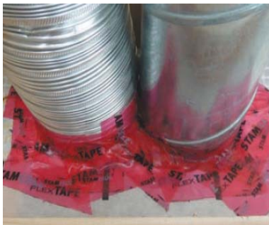
Exemple de mala col·locació de conductes
