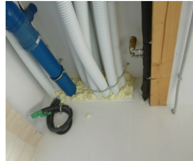
Exemple de mala col·locació de conductes
