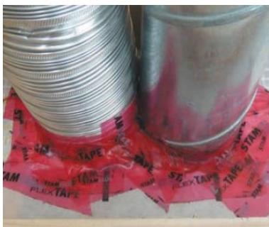
Exemple de mala col·locació de conductes
