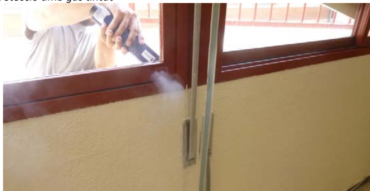
Detecció amb gas tintat
