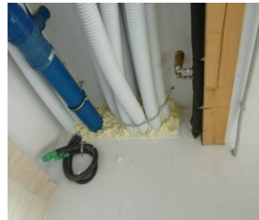
Exemple de mala col·locació de conductes
