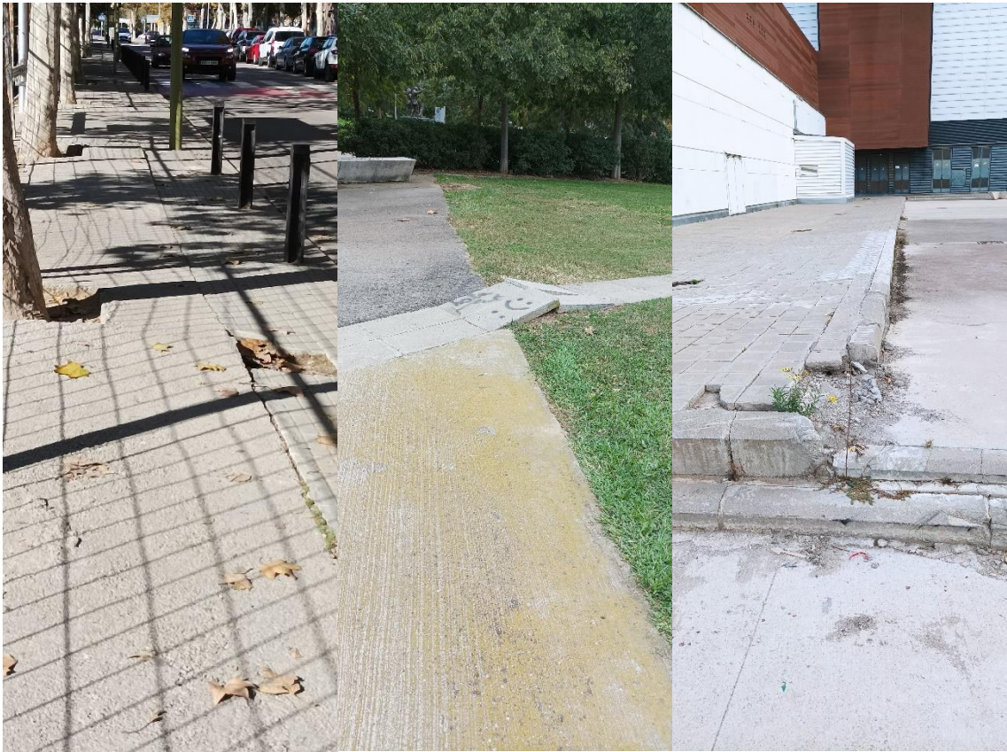
Presència de voreres en mal estat.
