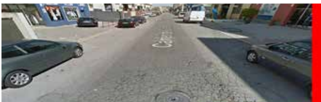
URBANITZACIÓ DEFICIENT Industrial Sud, Badalona
