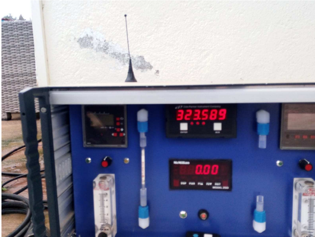
Figura 2. Punt de presa de mostres Masquefa, equip captador en mode manual.
