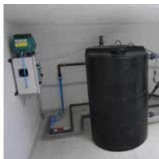
Sala d'emmagatzematge i tractament amb ozó de les aigües grises en un edifici residencial de Mataró Font: Grau i Molist, arquitecte (2010).
