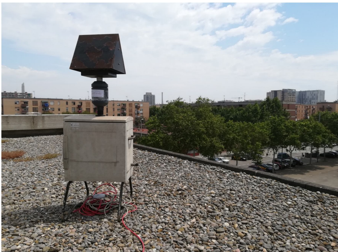
FIGURA 9. Equips instal·lats al sostre de l'edifici del CAP Besòs (Sant Adrià del Besòs).
