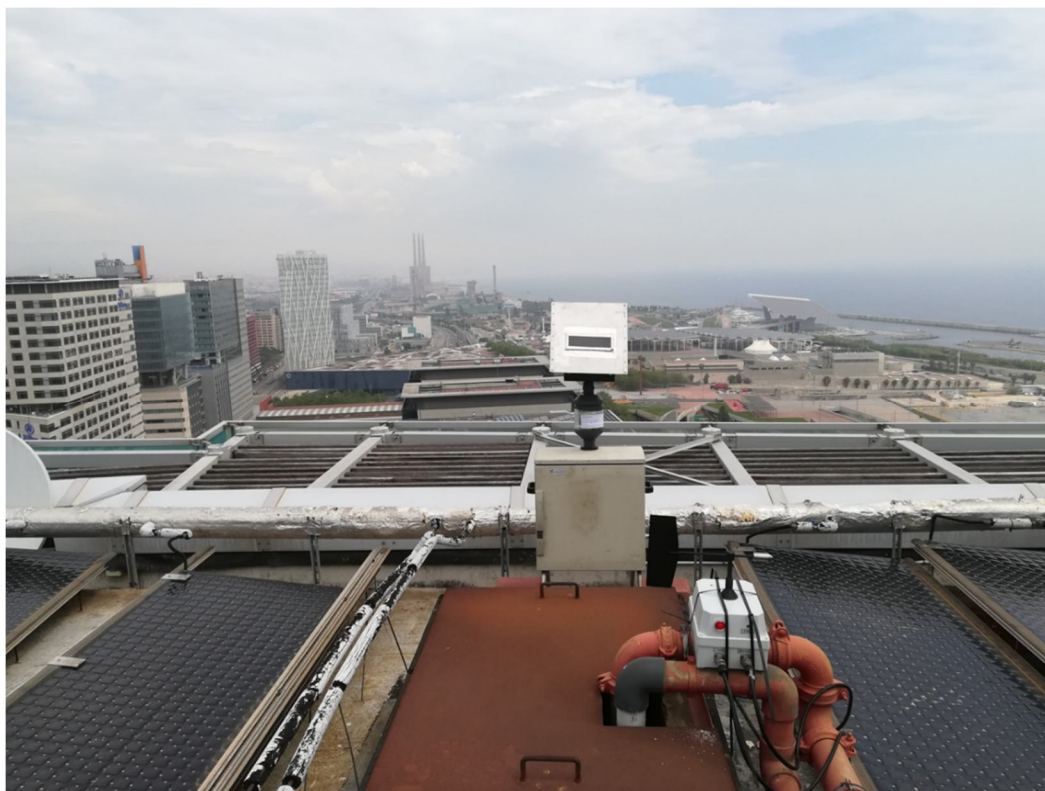
FIGURA 6. Equip instal·lat al sostre d'un edifici del Carrer Garcia Fària (Barcelona)
