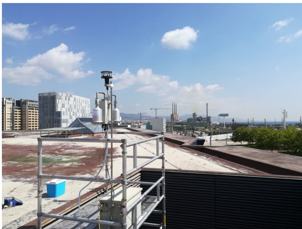
FIGURA 5. Equips instal·lats al sostre del Museu Blau (Barcelona)
