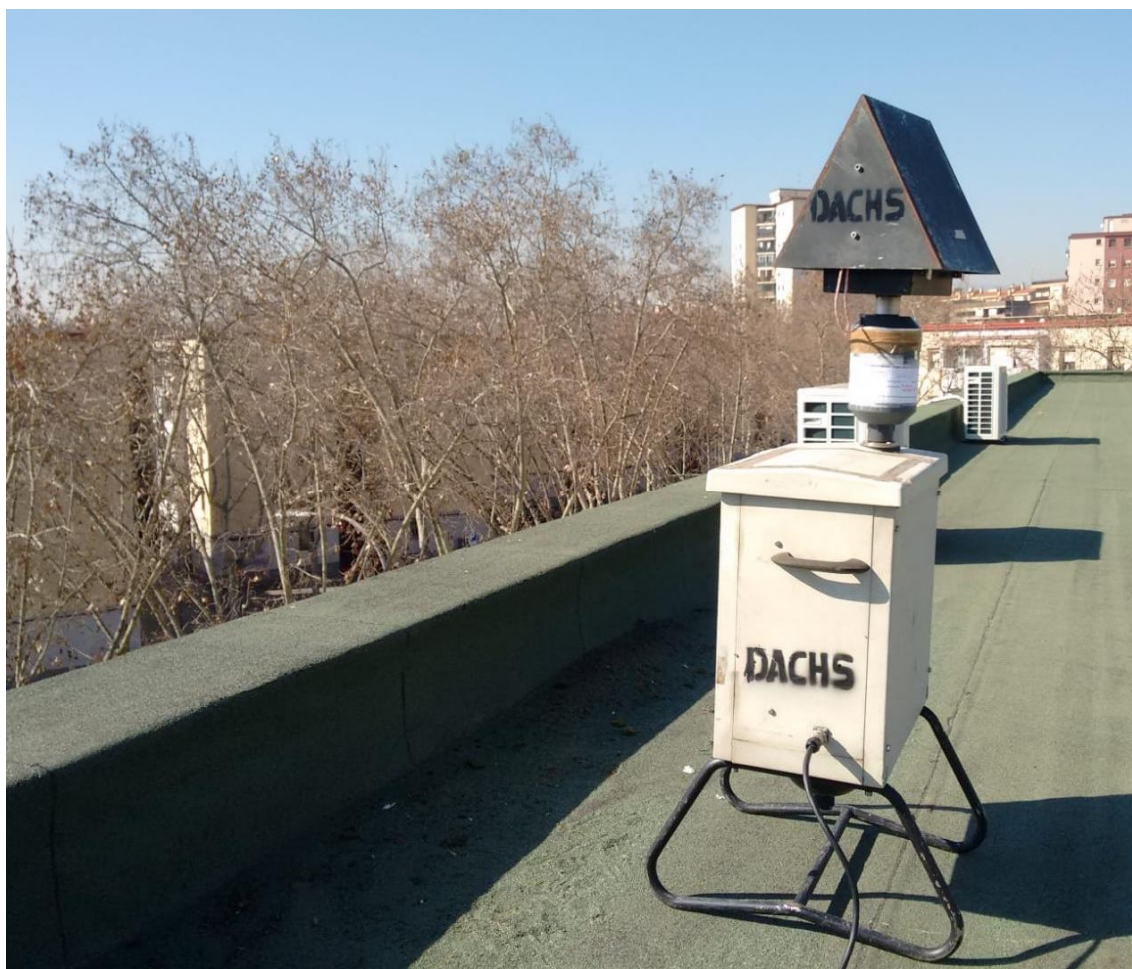
FIGURA 10. Equip instal·lat al sostre de l'edifici de l'escola Eugeni d'Ors (Badalona).
