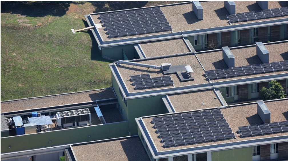
Instal·lació solar fotovoltaica al Centre Sociosanitari El Carme | Badalona
