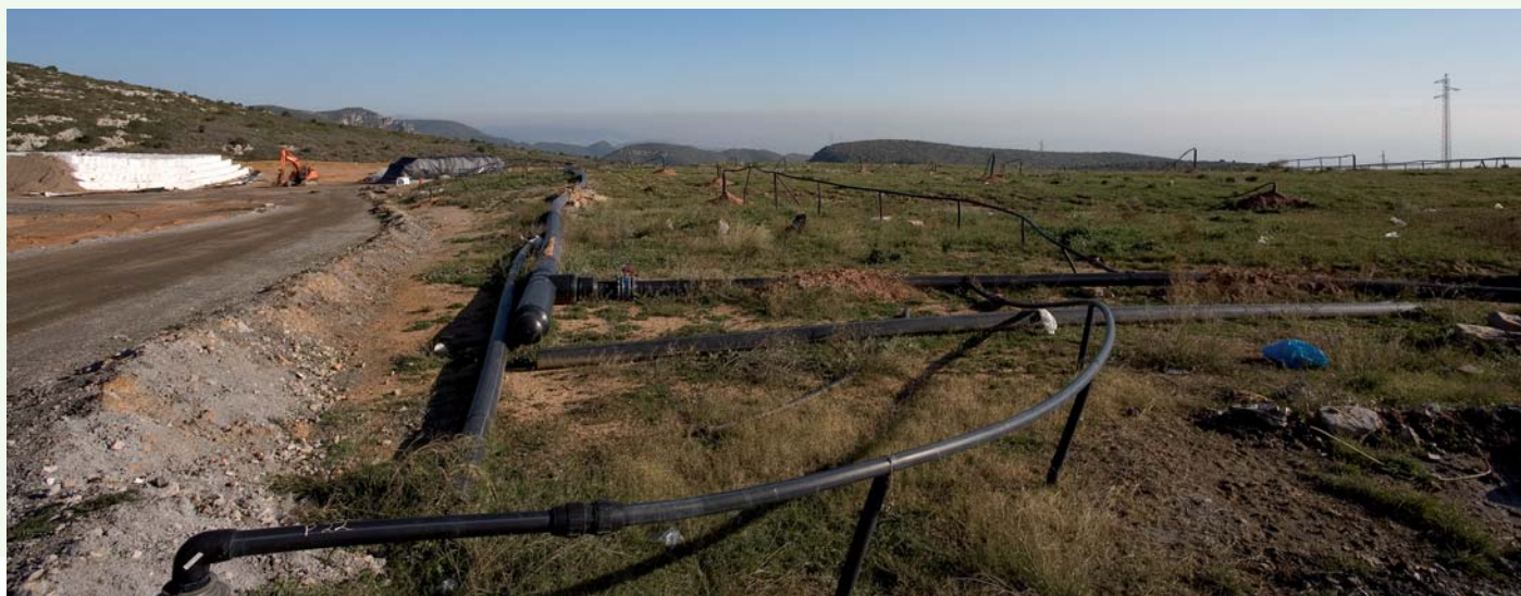
Sistema de captació de biogàs
