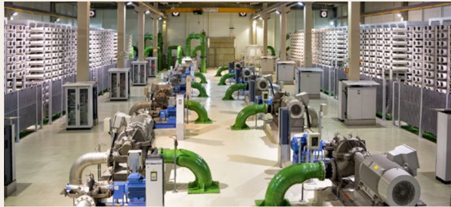
Estació de tractament d'aigua potable de Sant Joan Despí
